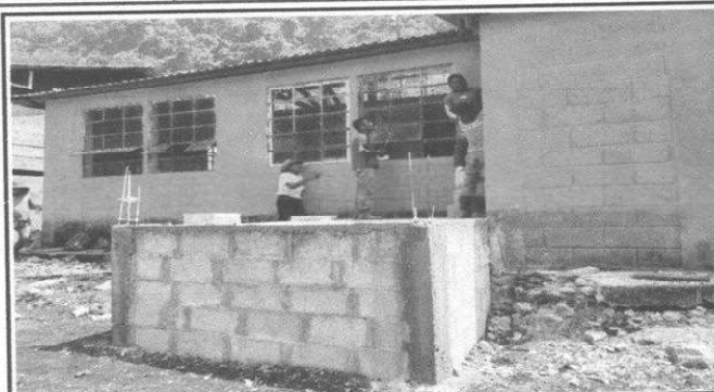
Foto 2: Se observa el mantenimiento de las ventanas de la escuela.
